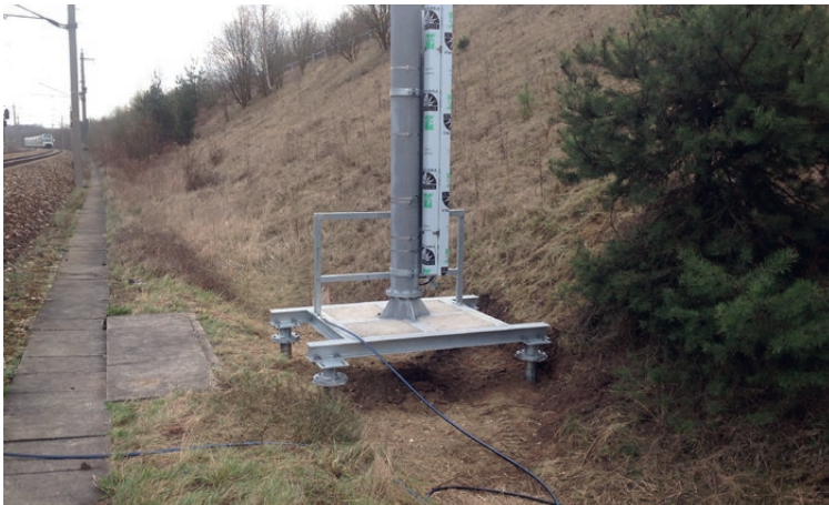
Funkmast an Bahnlinie, mit Unterkonstruktion auf 4 Schraubfundamenten
