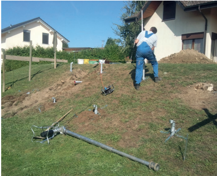
PV-Anlage in Montagny FR
