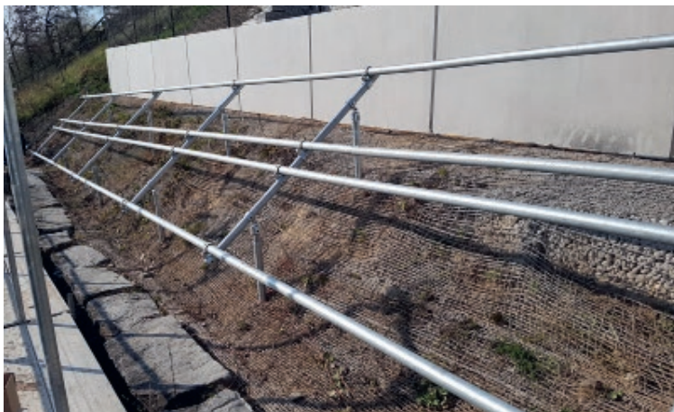
Unterkonstruktion für PV-Kleinanlage in Volketswil ZH
