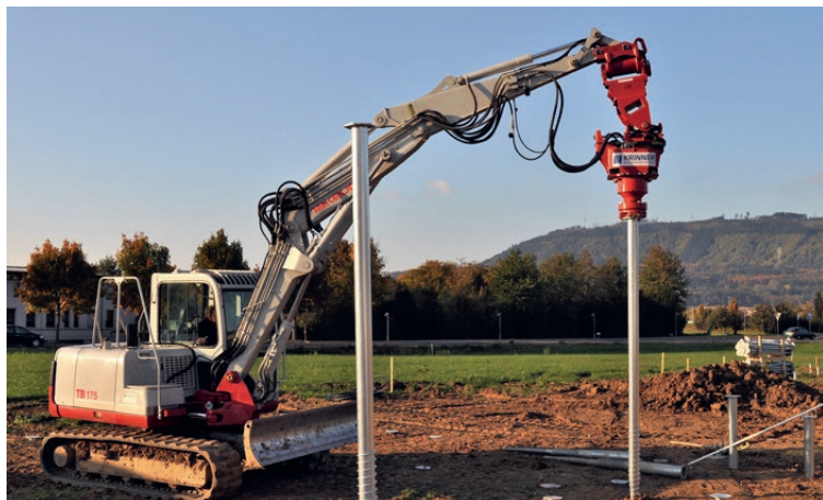
Pose de vis de fondation avec KRB 250 pelle rétro avec tête spéciale
