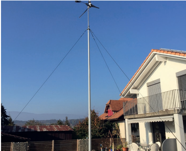
Eolienne à Walperswil BE
