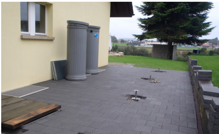
Fondations vissées série F-R avec support de poteau, prêtes pour la mise en place du carport
