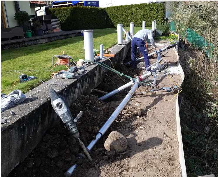
Sol qui s'affaisse Sur une maison individuelle dans le Fricktal AG
