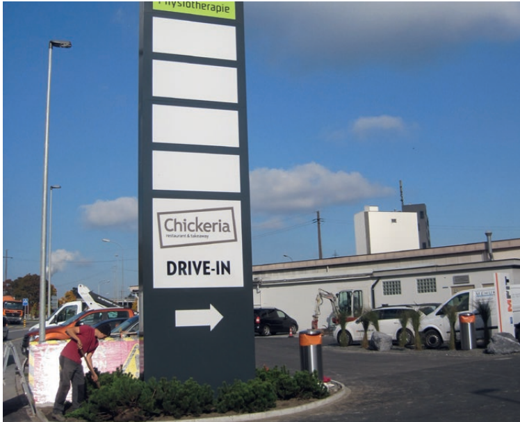
Pylone de 10m de haut
