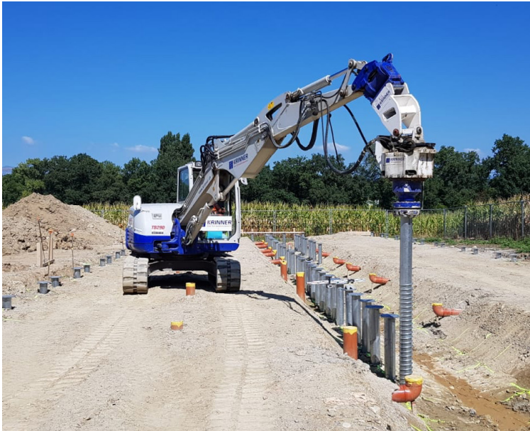
Mise en place des vis de fondation au moyen de la KR B 250
