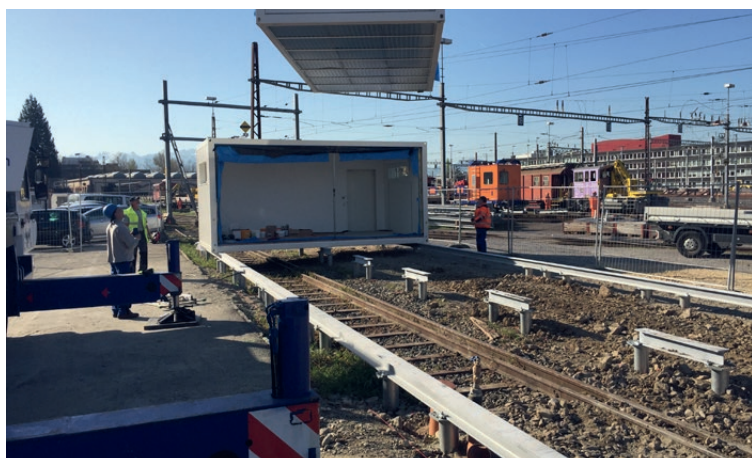
Pose des containers sur la structure métallique fixée sur les vis de fondation
