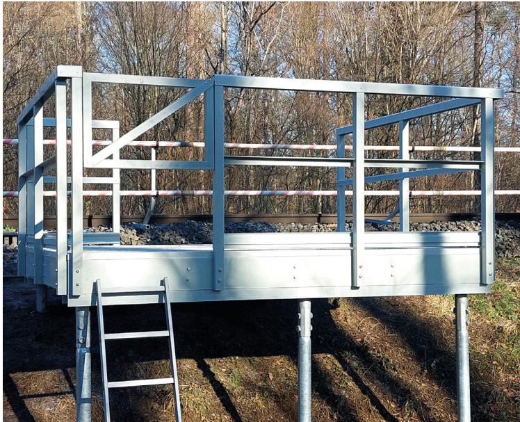
La compensation de la pente a été réalisée grâce aux fondations vissées de Krinner
