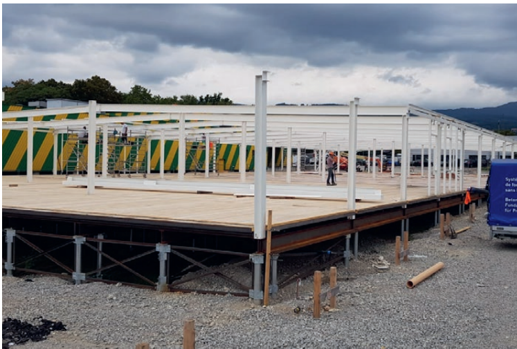
Gebäudeplattform mit Verstrebungen
