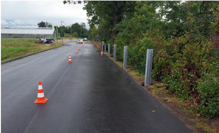
Stahlstützen auf Schraubfundamenten
