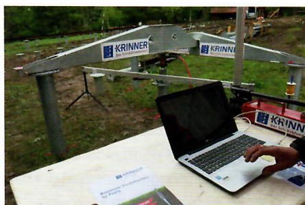
tandardisierte Fundamentprüfung: Ein Druckzylinder mit Kraftmessdose und eine laserbasierte Wegmessung erlauben die Aufzeichnung des Lastabtragverhaltens.
